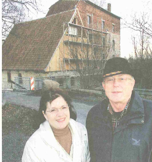
Denkmal: Karin und Hans-Georg Baumeister haben die Deppendorfer Wassermühle im Jahr 2001 gekauft – und sind seitdem mit der Sanierung befasst. FOTOS (2): S. TETMEYER
